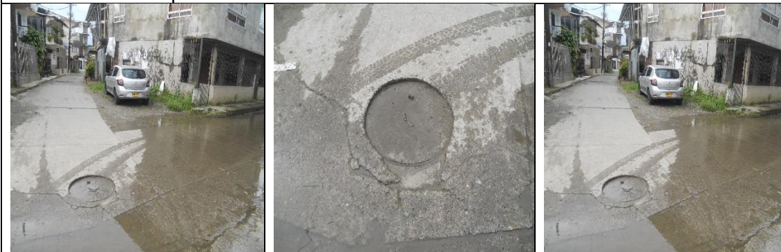
Pozo de inspección ubicado en la carrera 5b con calle 13 barrio Niño Jesús
