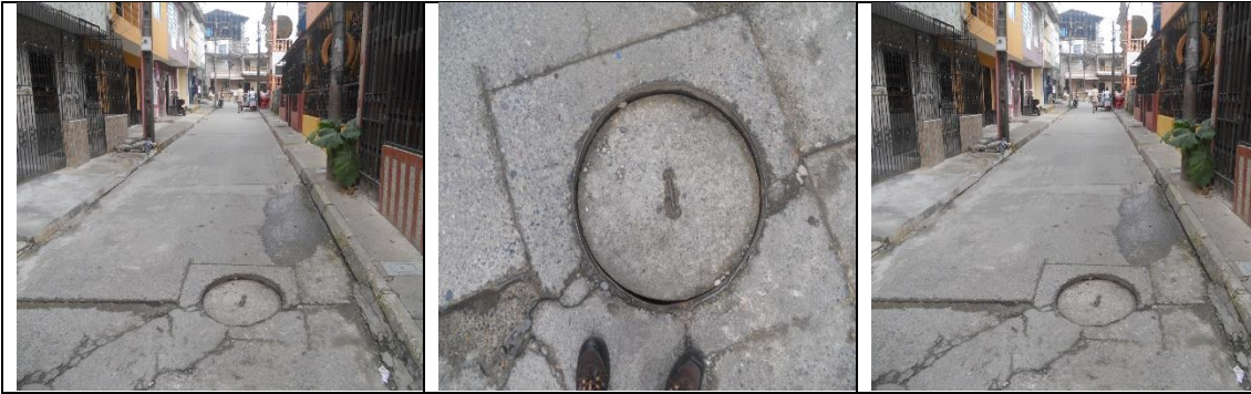
Pozo de inspección ubicado en la carrera 7 con calle 13 barrio Niño Jesús
