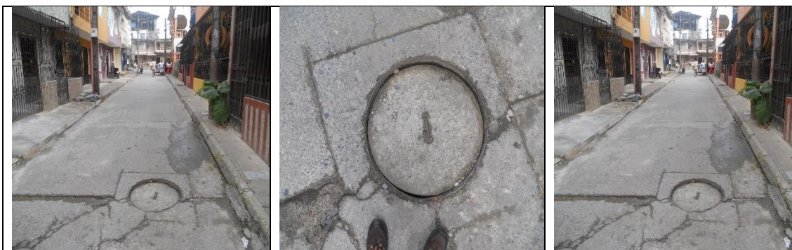
Pozo de inspección ubicado en la carrera 7 con calle 13 barrio Niño Jesús
