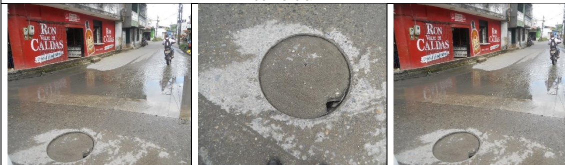
Pozo de inspección ubicado en la carrera 8 con calle 9 barrio Niño Jesús
