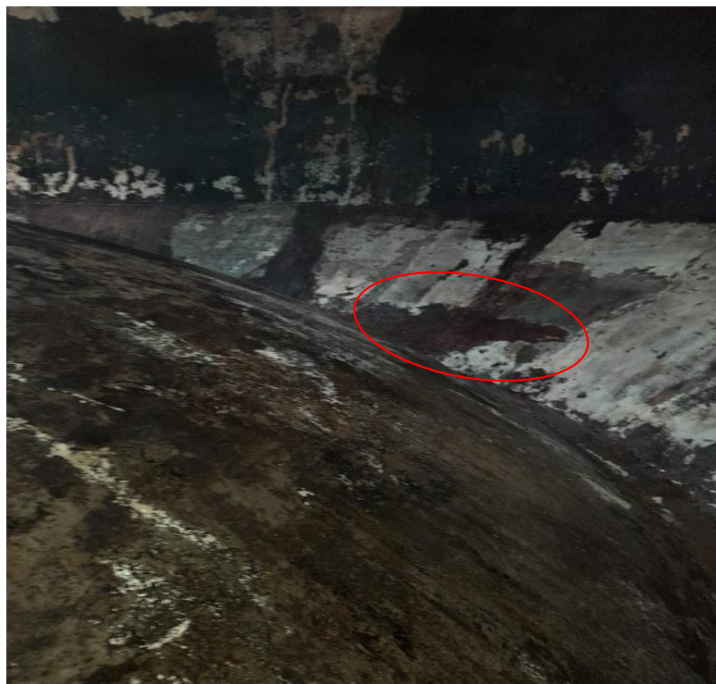
Fotografía 3. Del interior del tanque Loma - Deterioro
