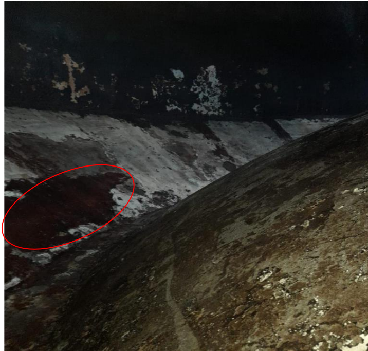
Fotografía 2. Del interior del tanque Loma - Deterioro
