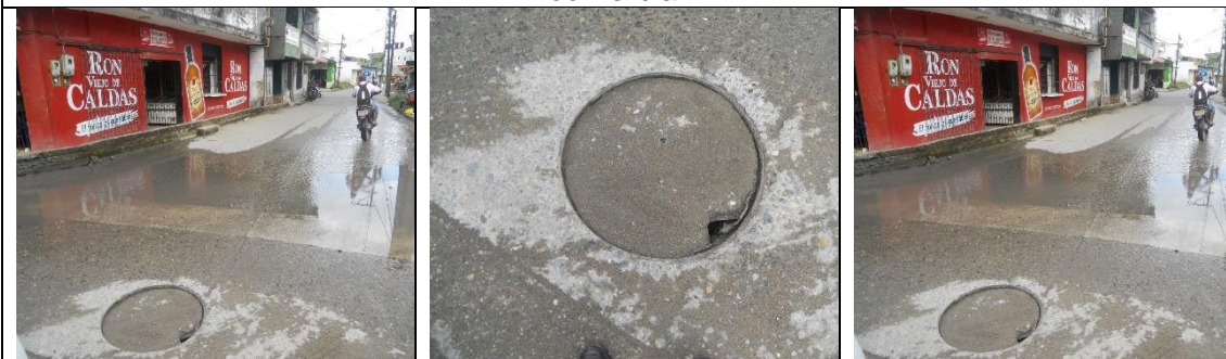
Pozo de inspección ubicado en la carrera 8 con calle 9 barrio Niño Jesús
