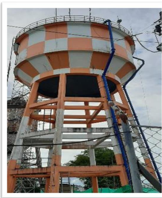
Antena en Tanque Elevado
