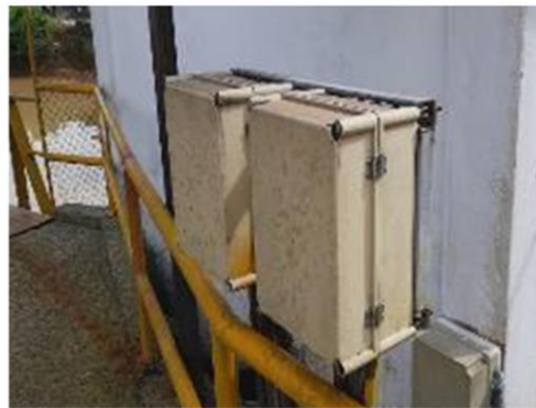
Sistema de control de macromedidores en Bocatoma
