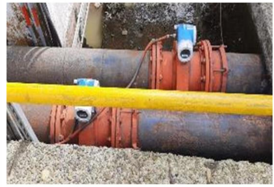
Sistema de control de macromedidores en Bocatoma
