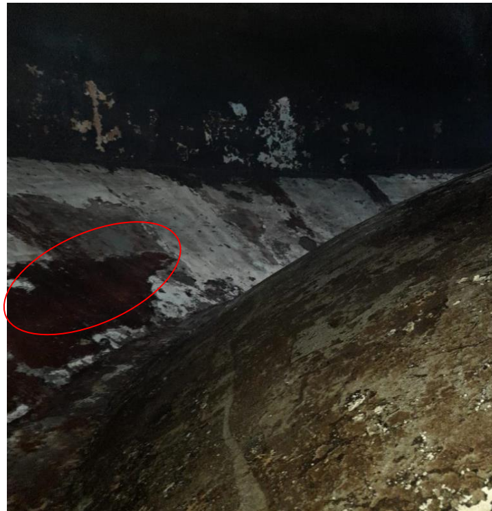
Fotografía 2. Del interior del tanque Loma - Deterioro
