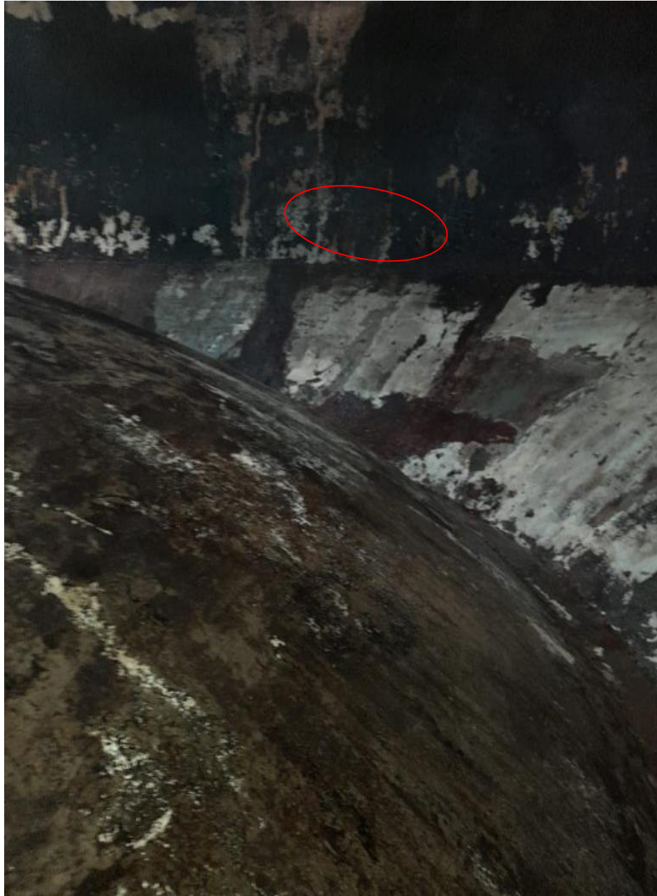
Fotografía 3. Del interior del tanque Loma - Deterioro
