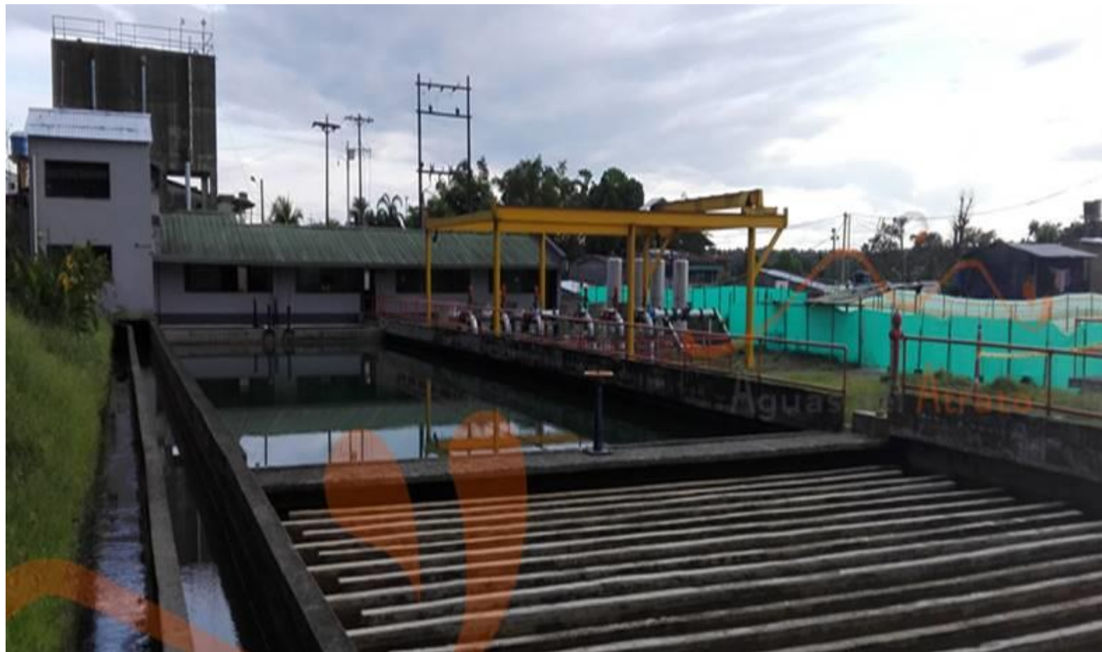
Fotografía N°3: Planta de tratamiento - Playita
