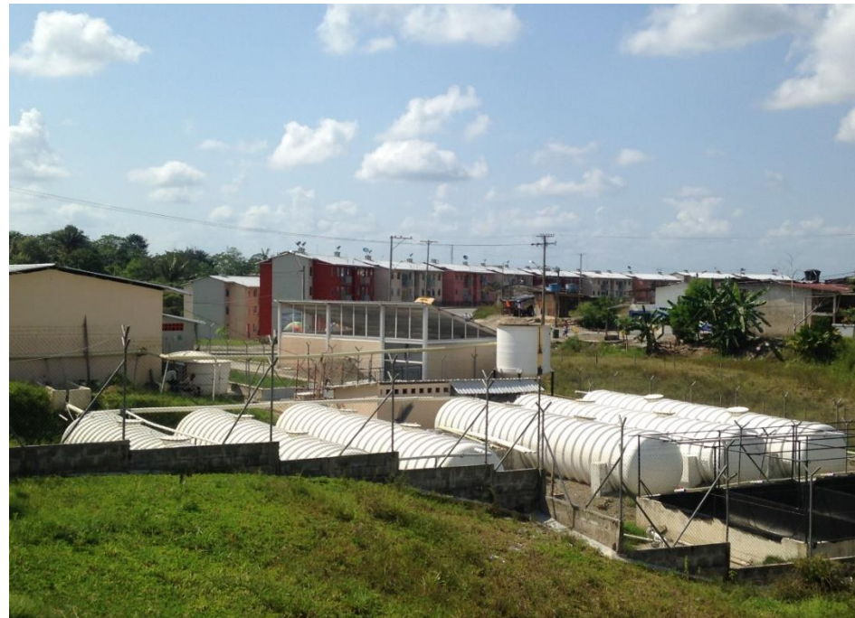
Fotografía N°6: Tanques de almacenamiento bajo.
