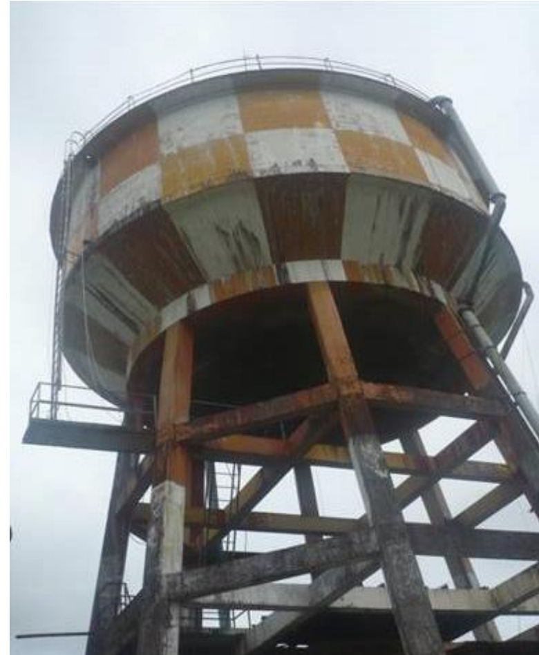
Fotografía N°1: Tanque elevado de almacenamiento Principal.
